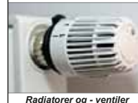
Radiatorer og -ventiler
